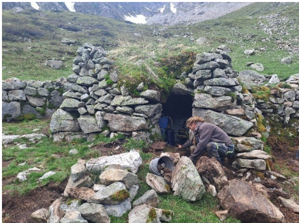
Fig. 2.17 & 2.18 (ci-dessous) : Purge de la façade est, installation du linteau de la porte.
