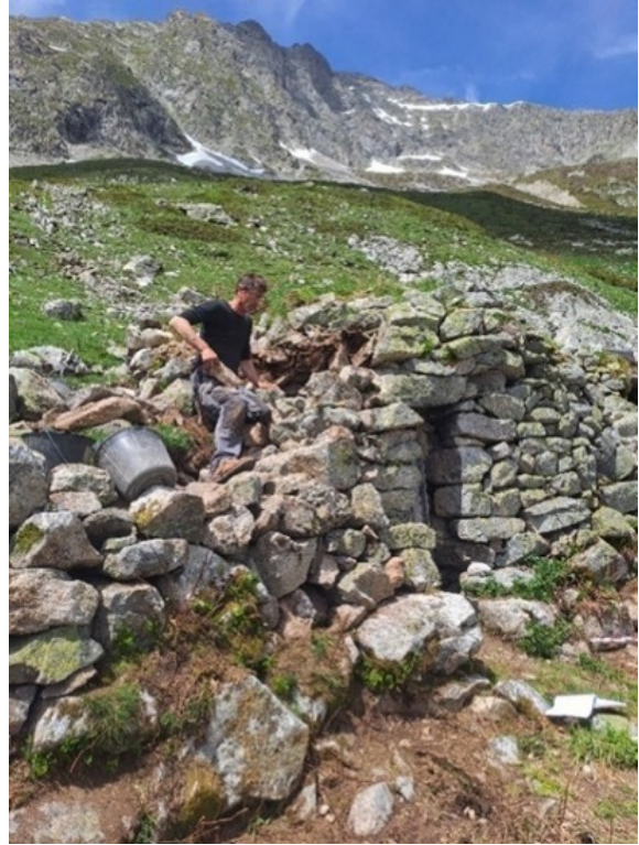
Fig. 2.29 (ci-contre) : Reprise de l'angle de la façade est et du mur sud.
