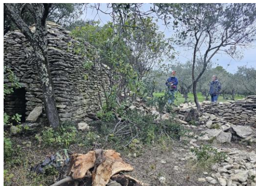
Fig. 10 : le mur de clôture effondré.
