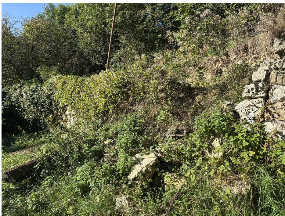
Fig. 01 : vue de la brèche dans le mur avant restauration
