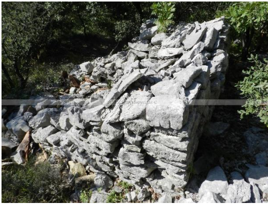
Fig.25 cabane ruinée dans le ravin
